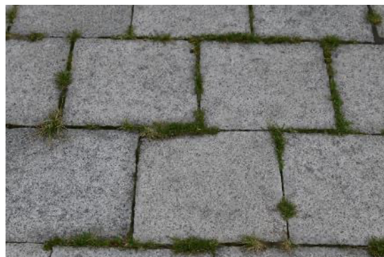
図 3-5-1-13b 室堂山荘前の石畳の隙間にスズメノカタビラ
